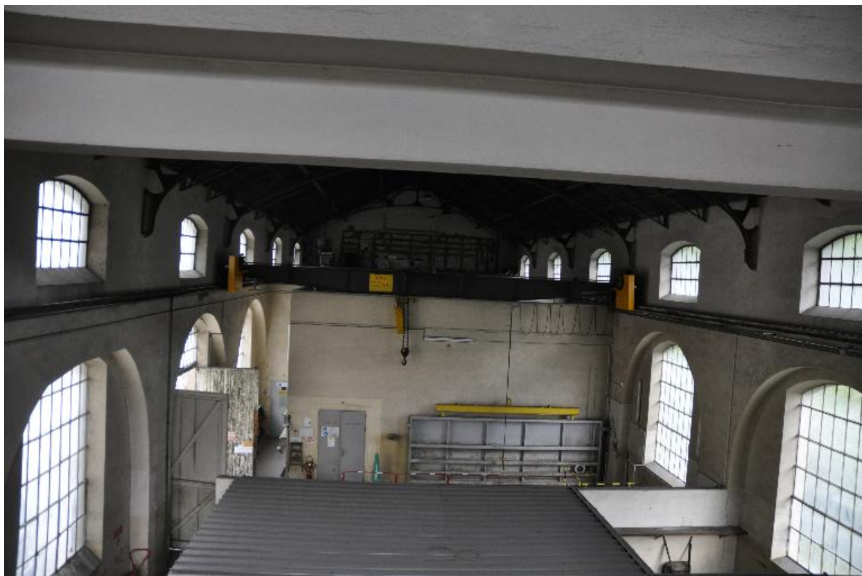
Vue du pont roulant du bâtiment à la charpente métallique
