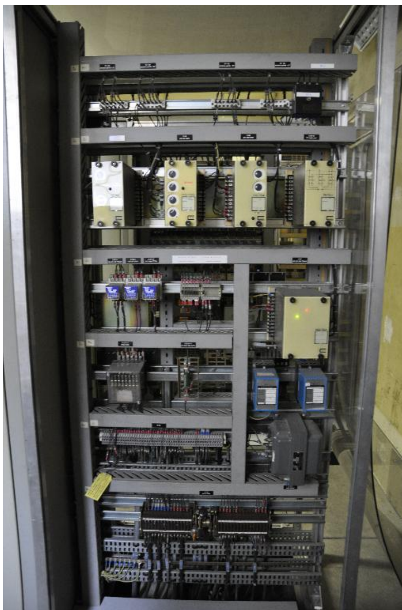
Vue d'une armoire électrique
