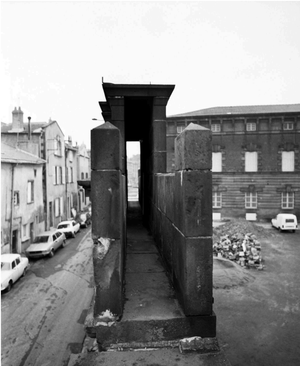
Mur de clôture sud, vue de la coursière située au dessus de la porte d'entrée de la prison.
