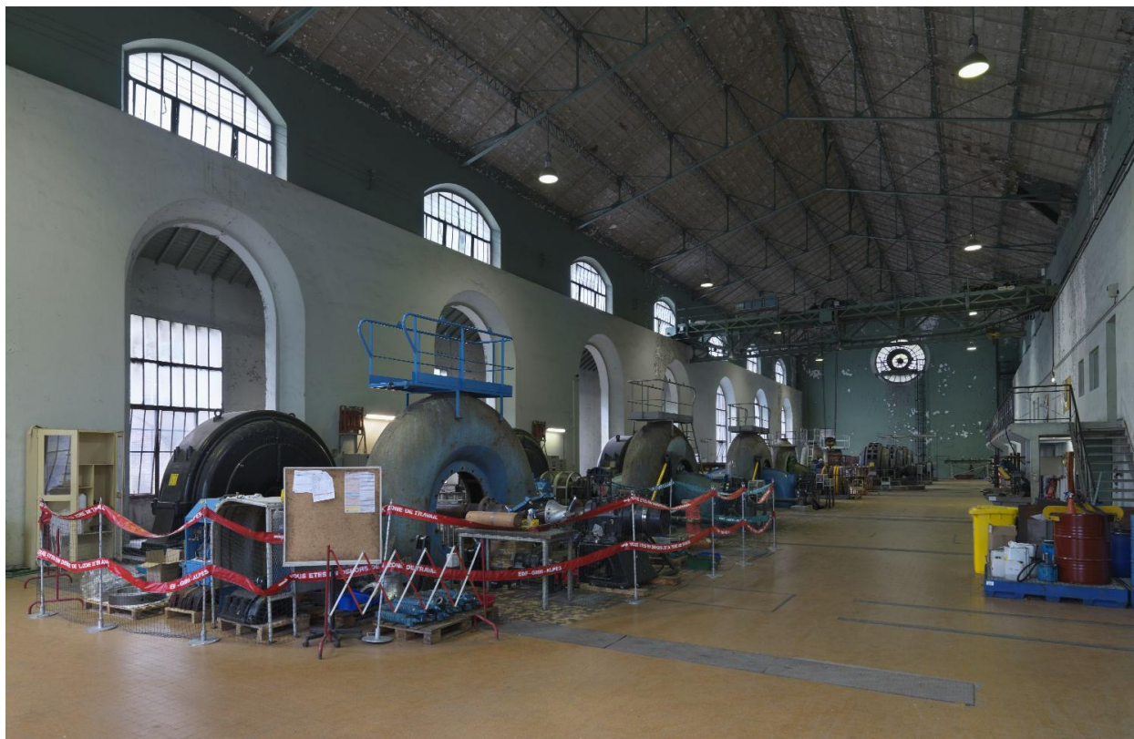
Vue intérieur de la centrale de Rioupéroux
