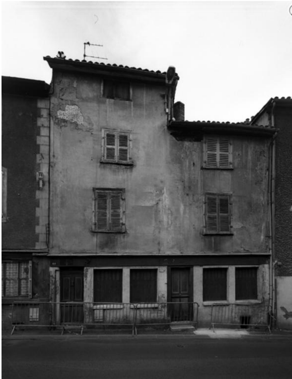
Maison au n° 30 de la rue, avant sa démolition et sa reconstruction.
