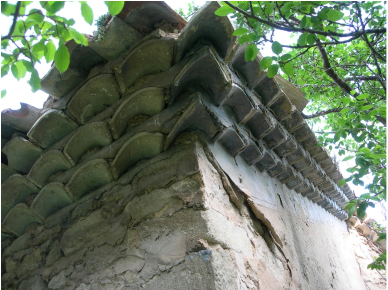
Montbrison-sur-Lez, La Viale : exemple de mise en oeuvre de génénoise sur l'angle d'une élévation.
