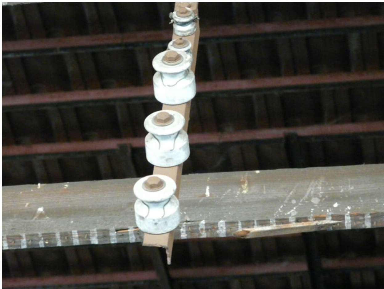
Détail porcelaine du circuit électrique
