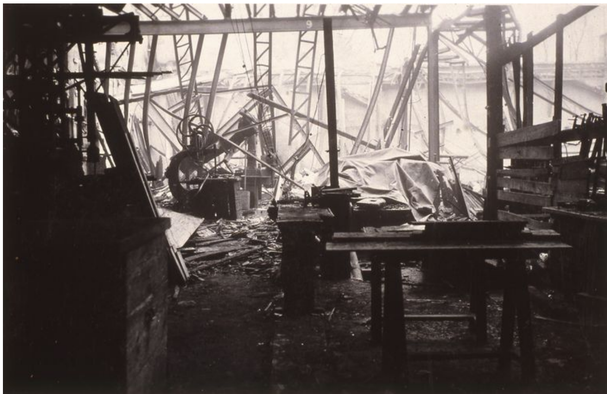
Les ateliers détruits par l'incendie de 1942
