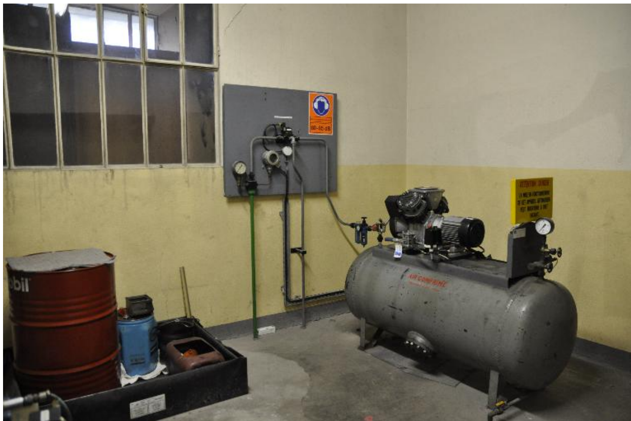
Vue d'un compresseur
