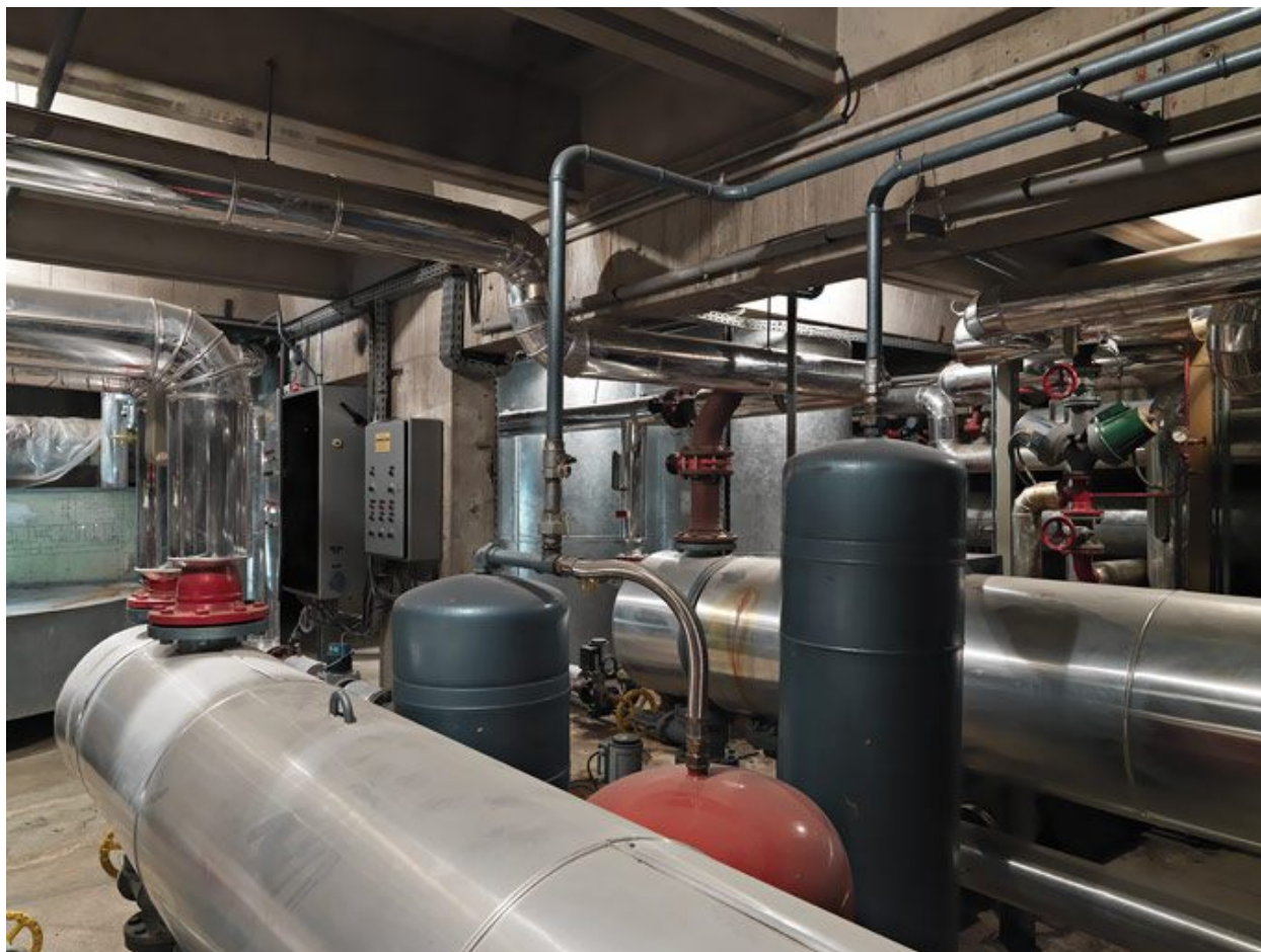
La sous-station de la galerie marchande
