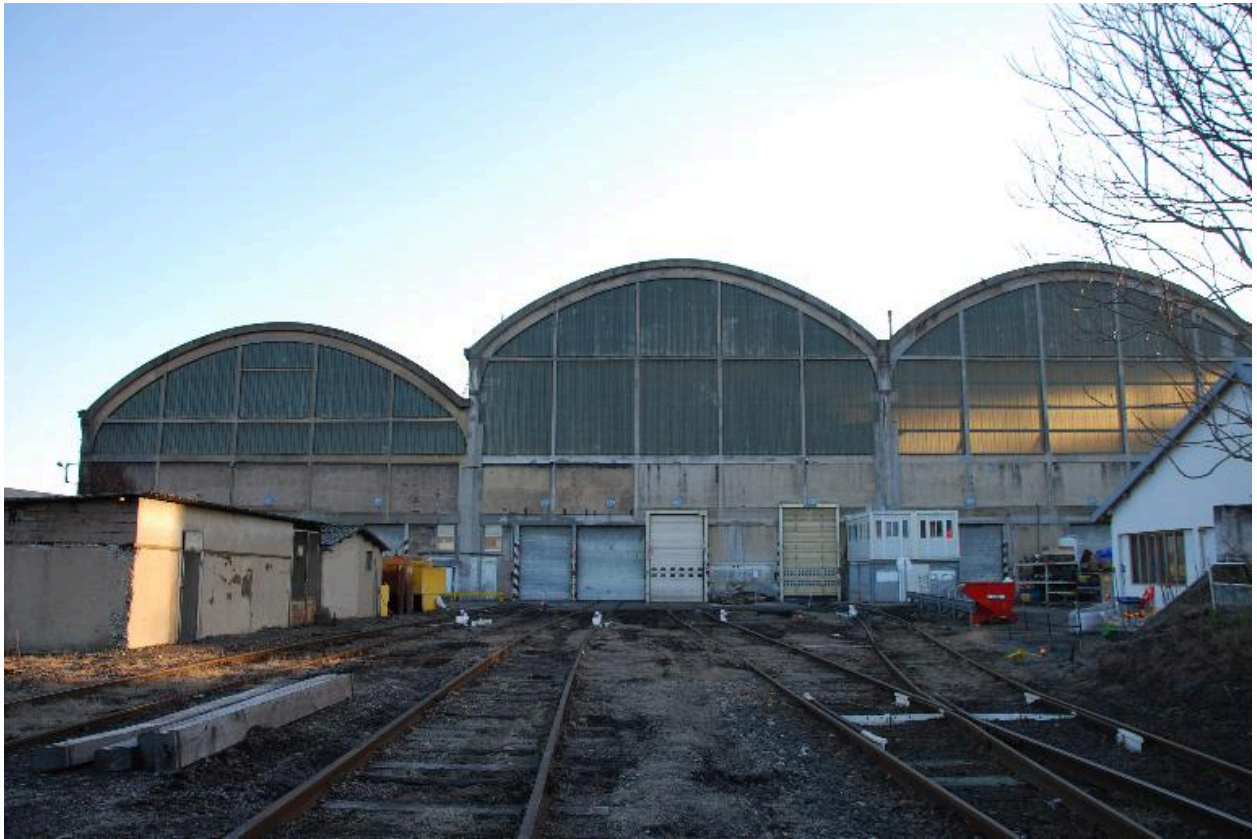
Vue nord atelier locomotives, levage de caisse et bloc électrique construction 1920 et 28 pour la 3eme à gauche.
