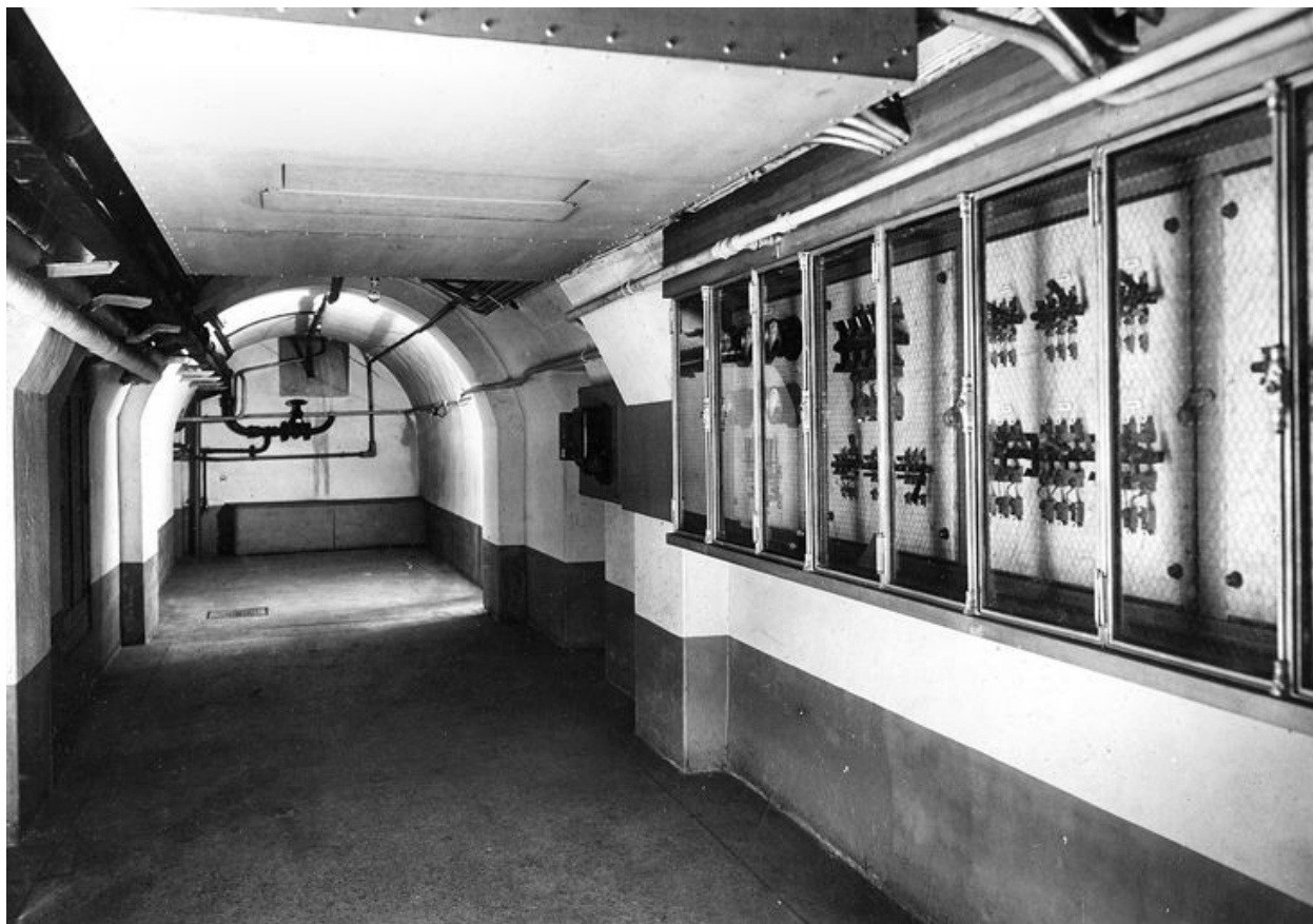
Vue des installations techniques, en sous-sol (1925) (Banque de France, PHAR, non coté, photographie).
