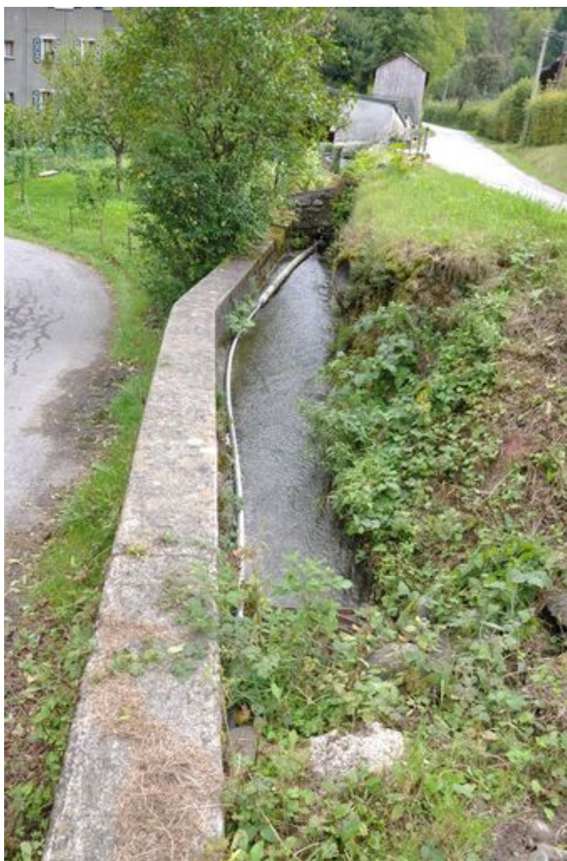
Canal de fuite sortant de la centrale hydroélectrique du Pignet
