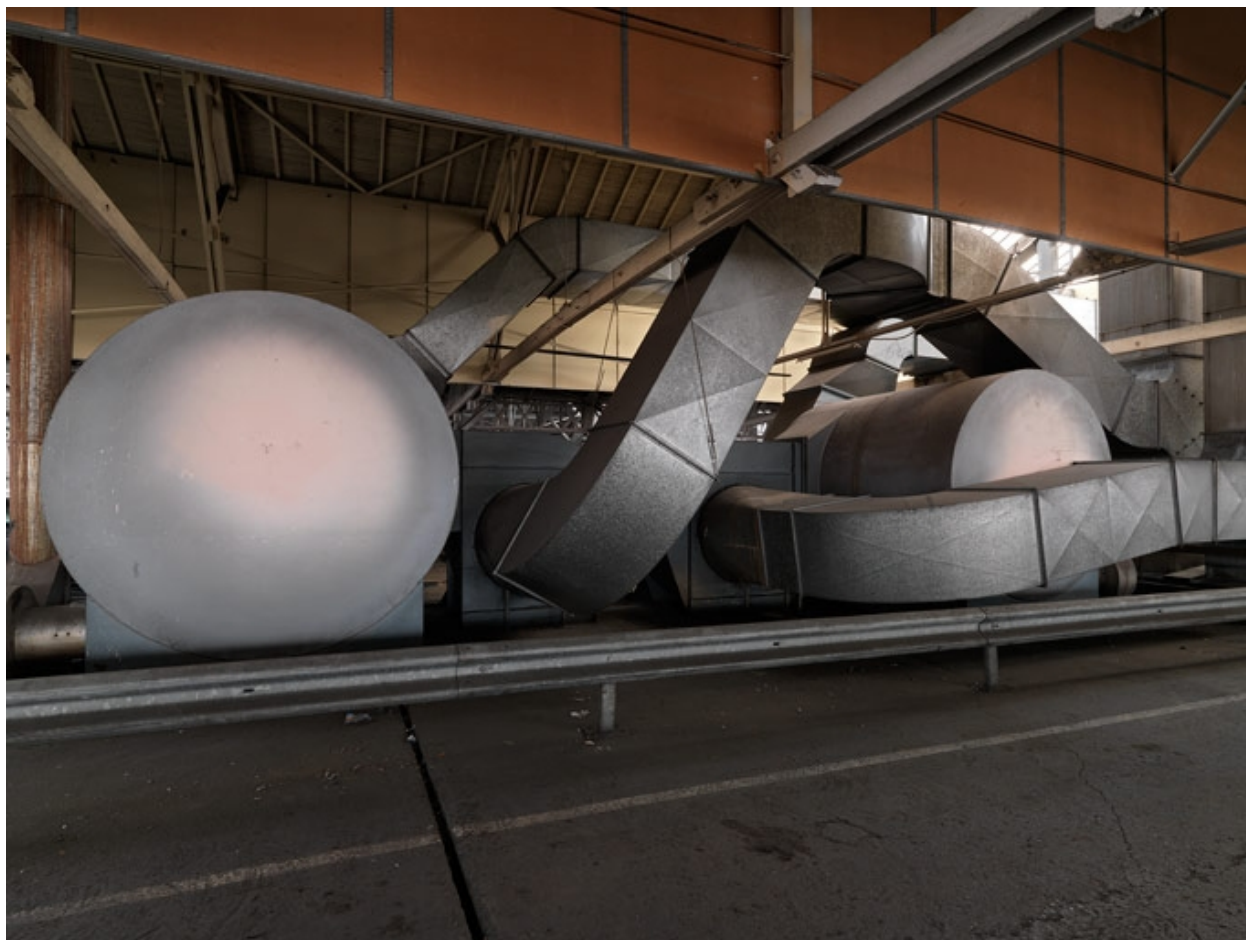
Machinerie de ventilation et chauffage
