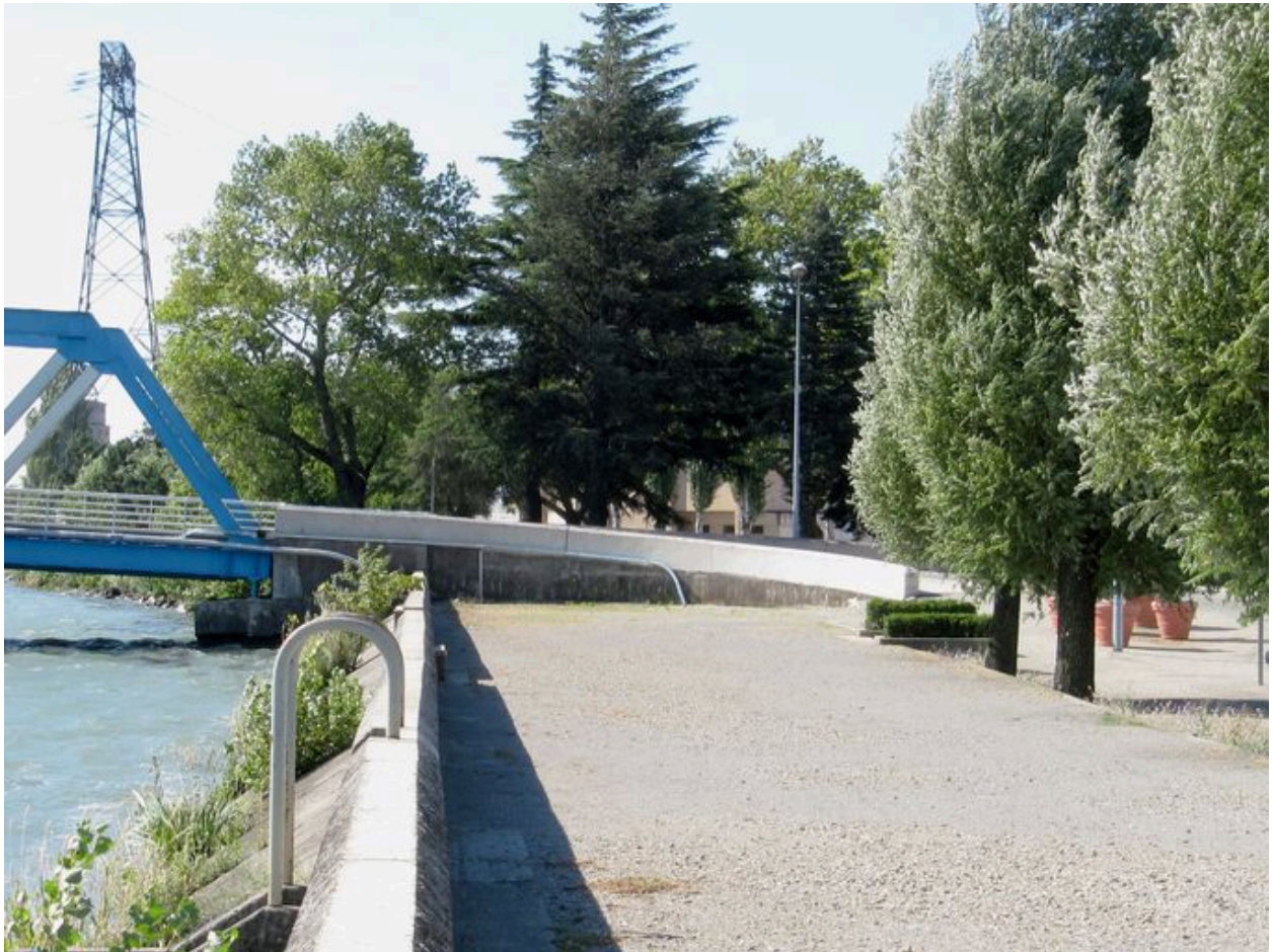
Culée droite et débouché, face amont, vue générale (depuis la rive droite)
