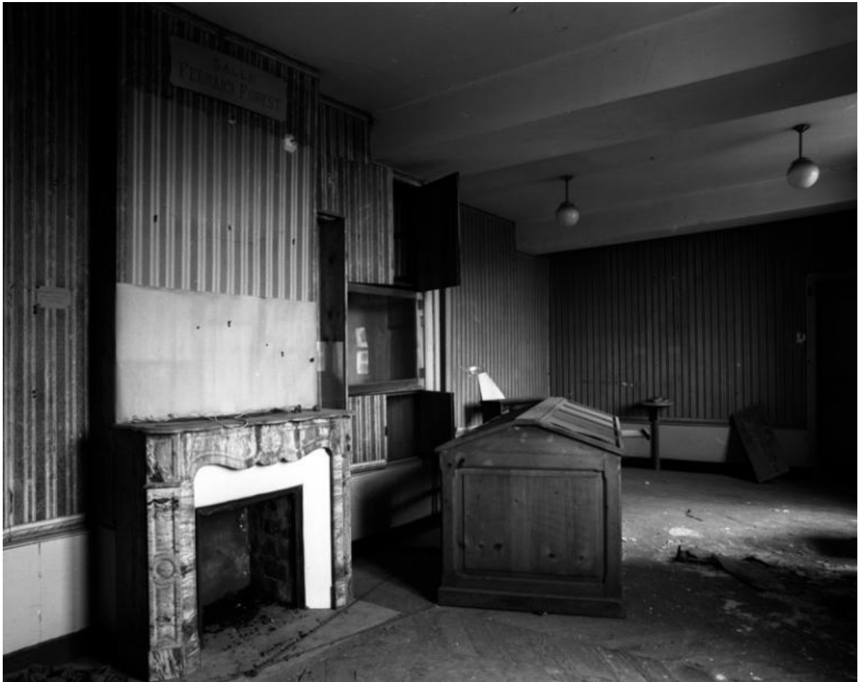
La salle dite "Fernand-Forest", ouvrant côté sud, au 1er étage - détruite lors des travaux de 2008 (salle +1.4 du plan schématique).
