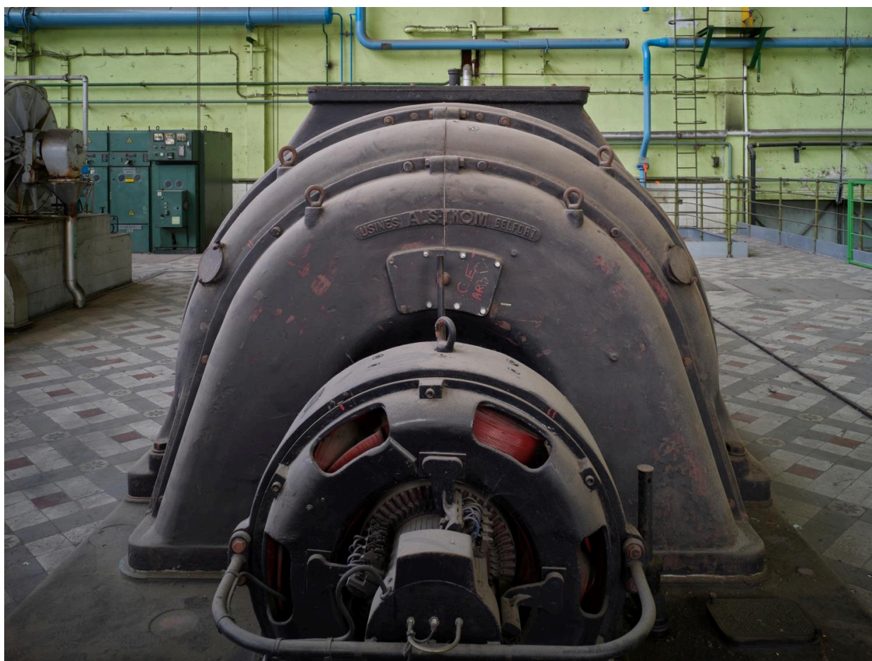
Turbine de l'ancienne chaufferie, dans le bâtiment B41.
