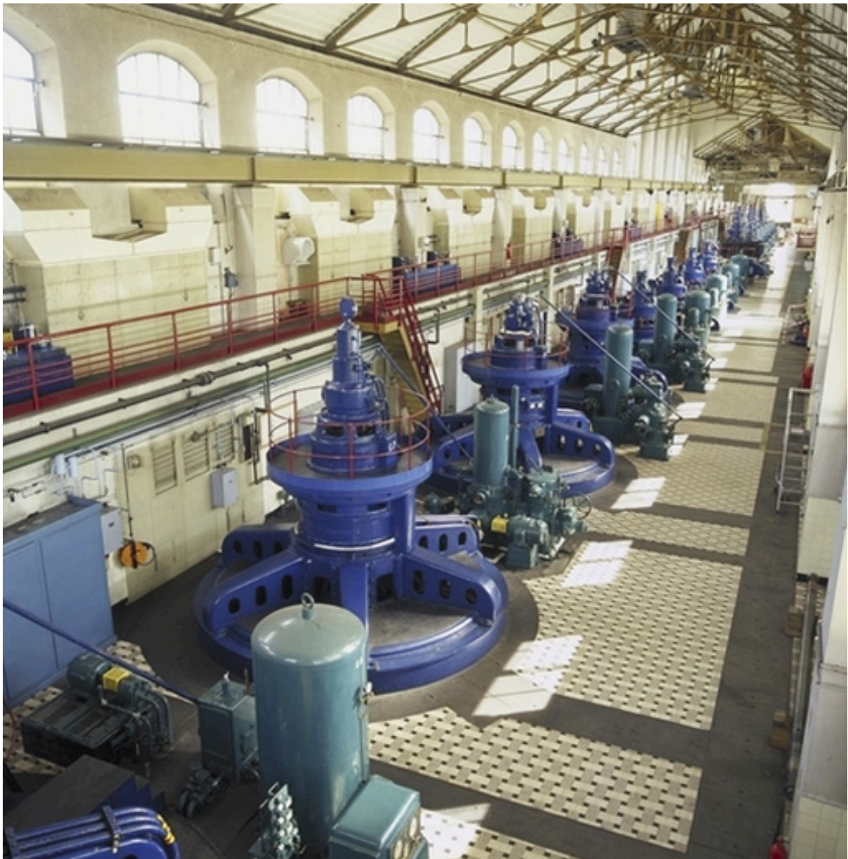
Salle des machines vue sud
