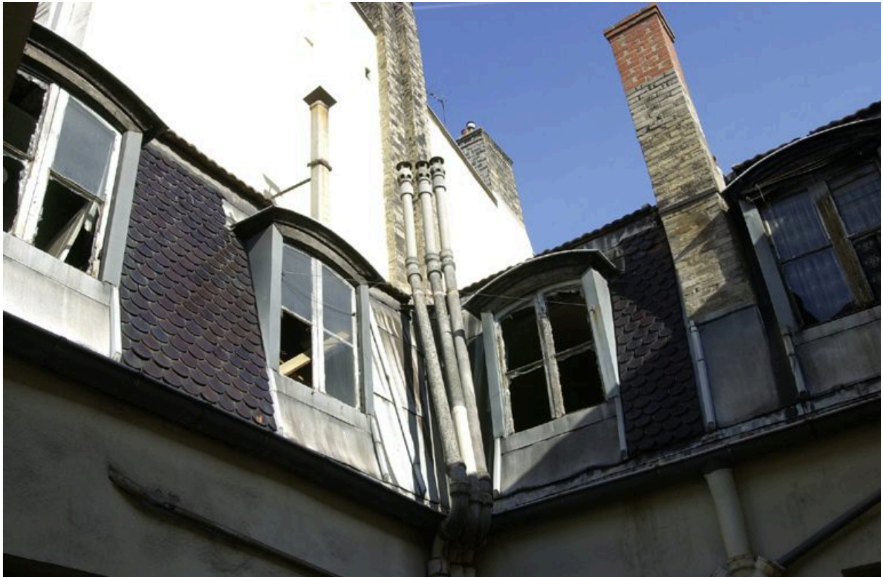
Les lucarnes des élévations nord et ouest de la cour depuis la cage d'escalier
