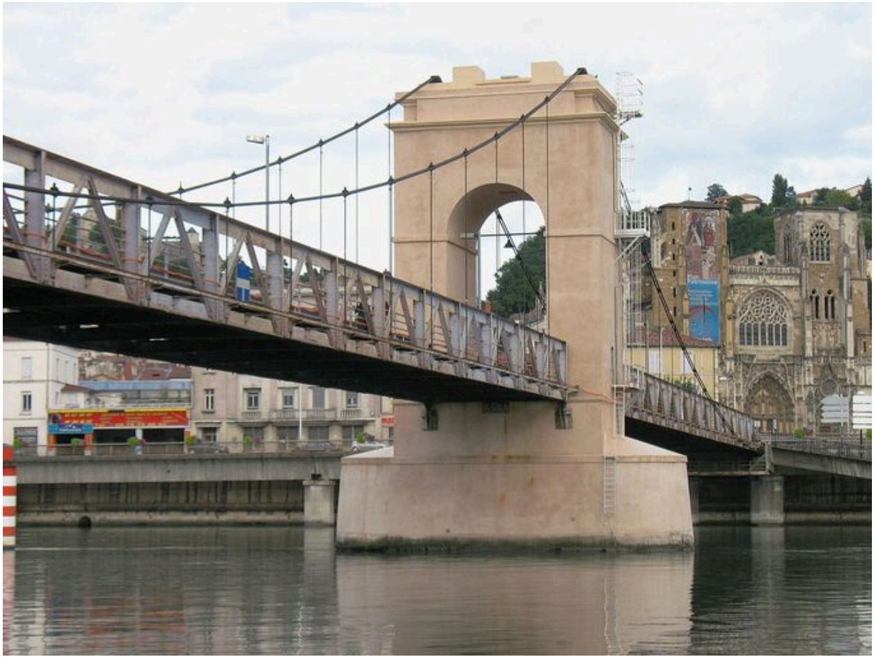
Vue partielle, travée droite et pile centrale, face aval (depuis la rive droite)
