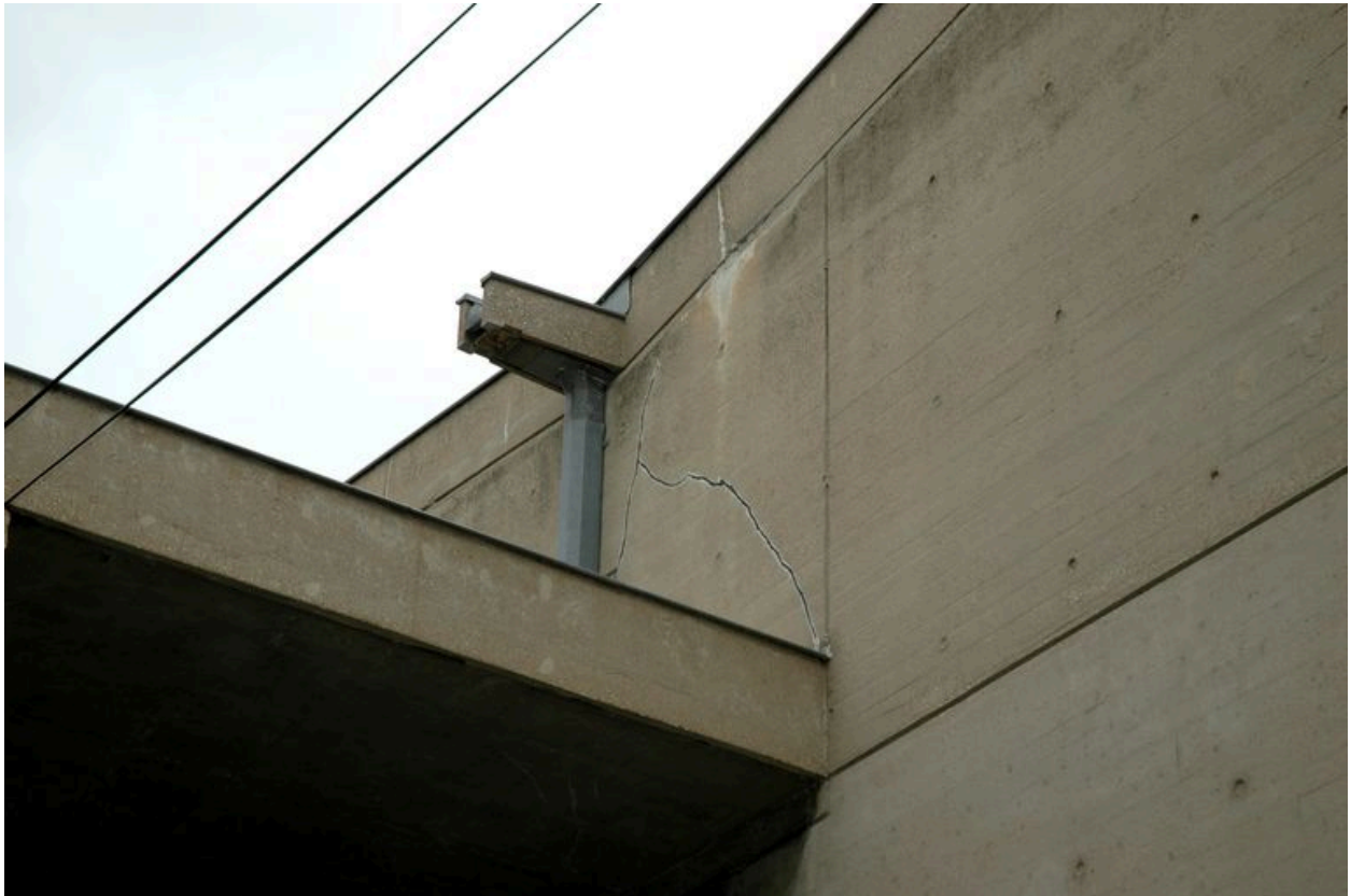
Détail des fissures de la façade
