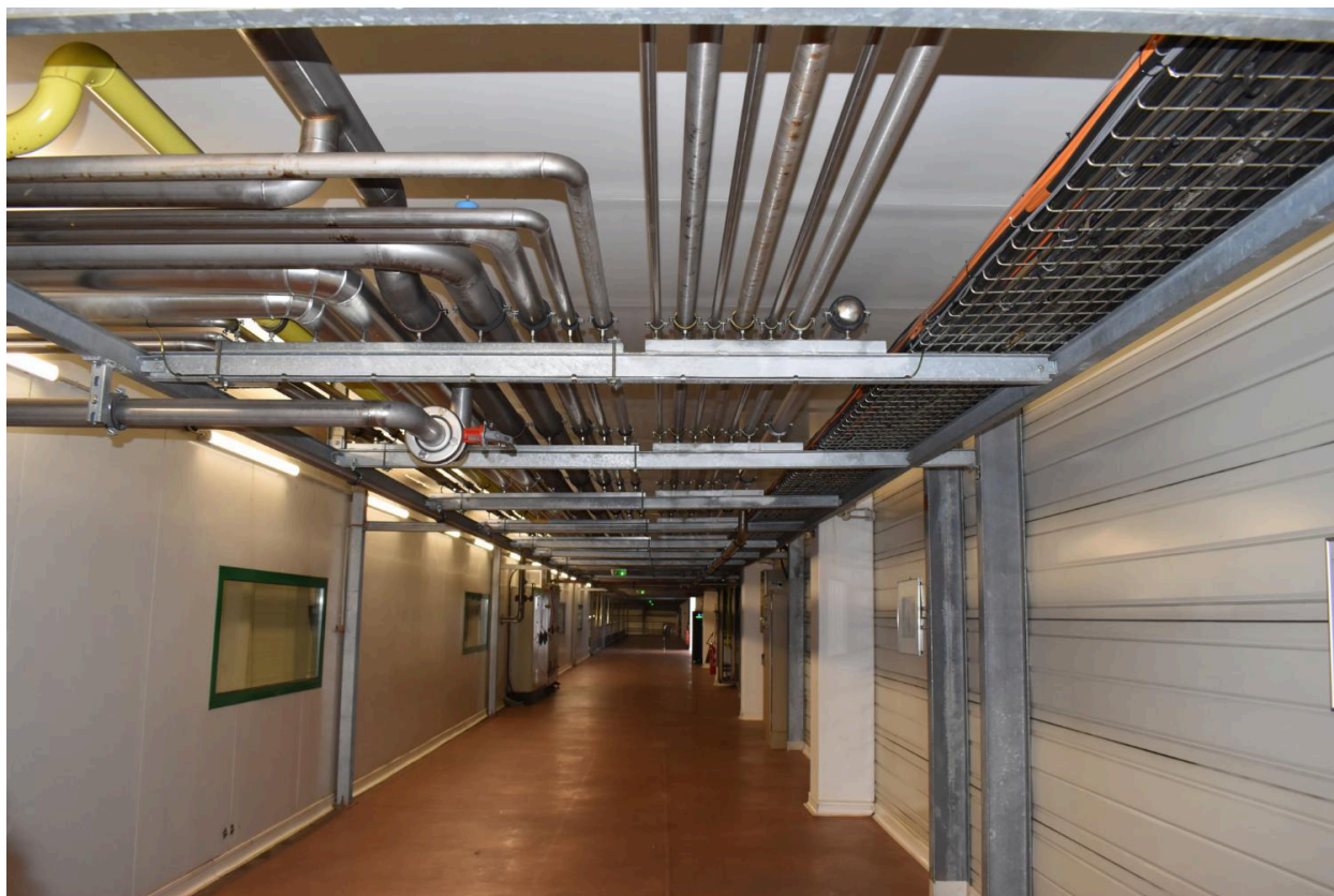
Vue des circulations d'eau
