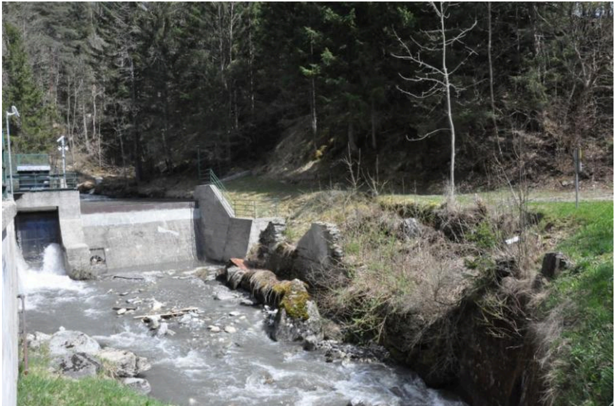
Prise d'eau sur le Grand Nant de Nâves.
