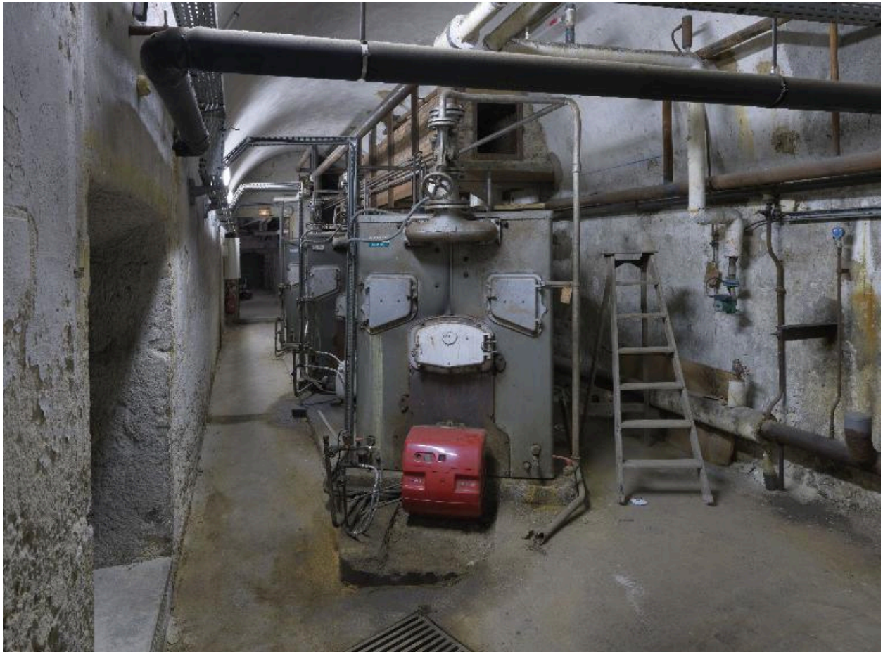
Prieuré, intérieur, sous-sol : chaufferie, côté ouest
