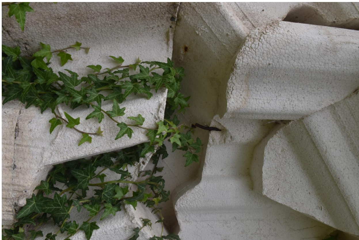
Détail avec fixation métallique apparente, oxydée
