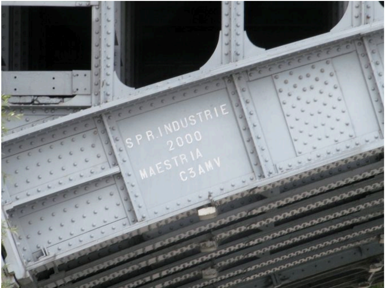
Arche gauche, face amont, vue de détail : inscription (depuis la rive gauche)
