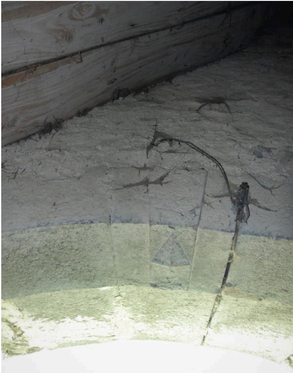
Vue intérieure du clocher : détail de l'intrados de la porte vers l'extérieur.
