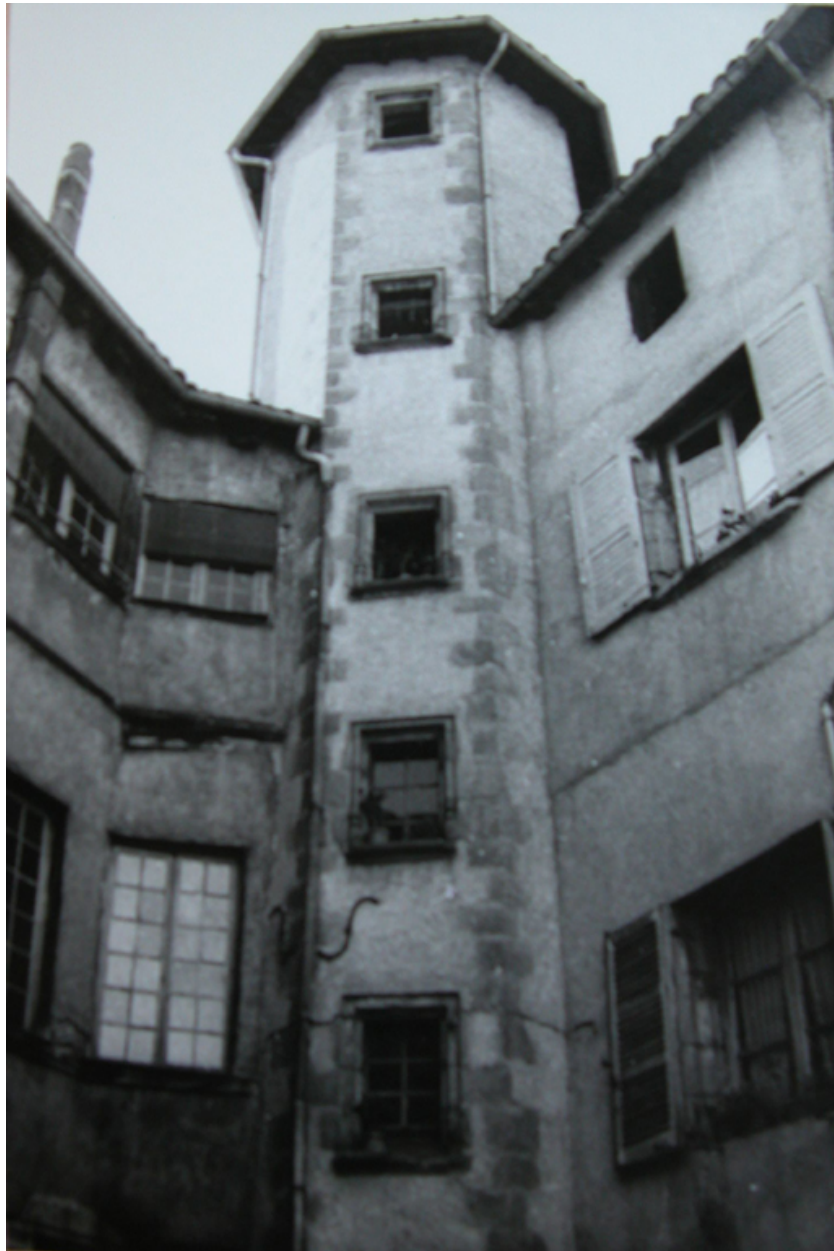
Cage d'escalier demi-hors-oeuvre, sur cour. Prise de vue avant restauration, 1975 (fonds Louis Bernard). photographie noir et blanc AD Loire. 1111 VT 128
