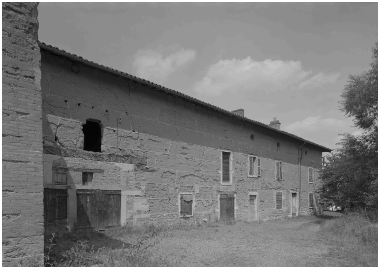
Ferme de type B (plan en L), sur la commune de Jassans-Riottier, lieu dit en Grillet (parcelle B2 154). Ferme en pisé sur solins de calcaire, encadrements en pierre, bois et brique.
