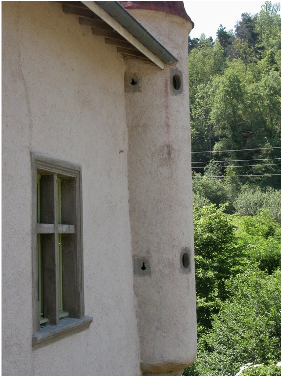
Vue de la façade ouest et de la tourelle en surplomb de l'angle sud-ouest.
