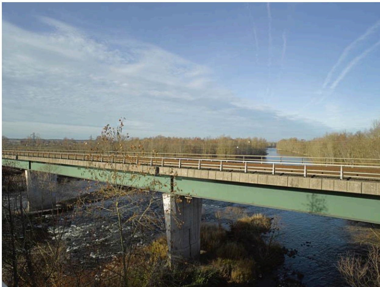
Traversée de l'Allier par la ligne de chemin de fer, au sud-ouest de Saint-Germain-des-Fossés.
