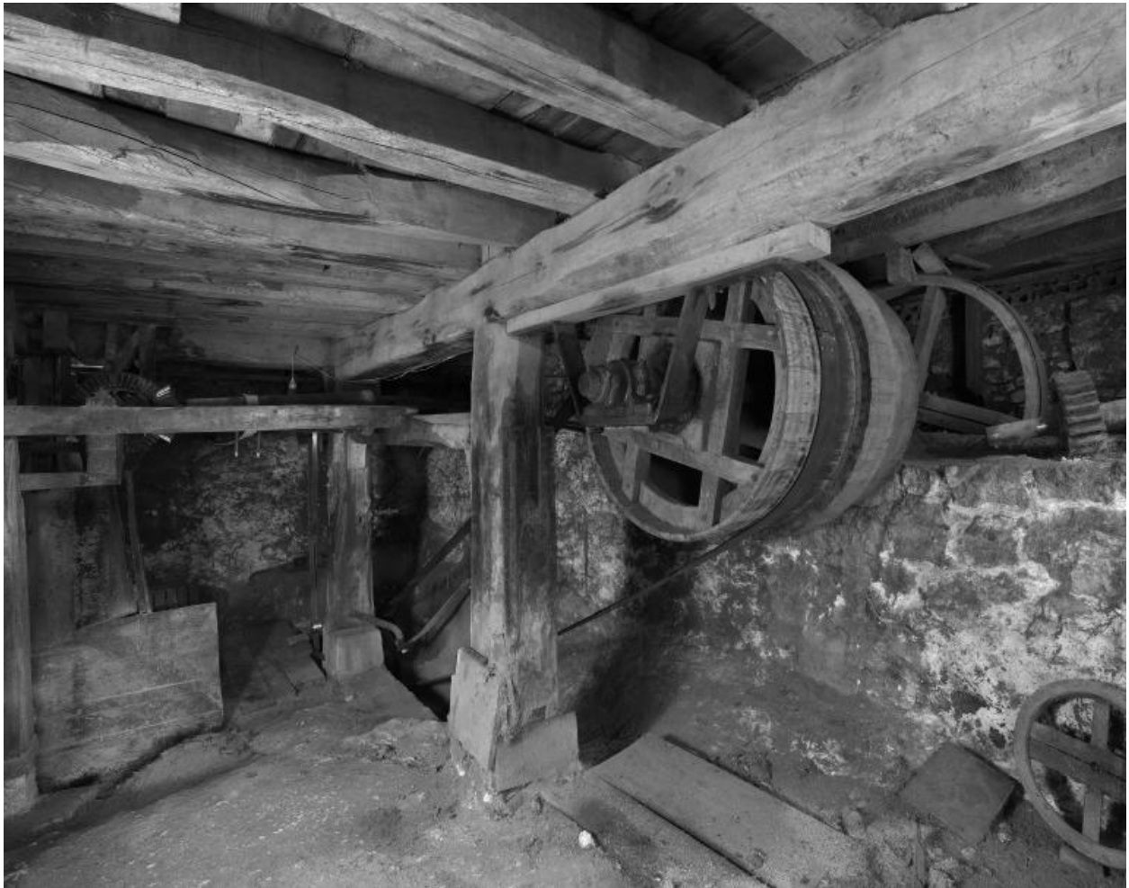
Vue intérieure du sous-sol : système d'entraînement de la lame battante et du chariot, axe de la roue à aubes.
