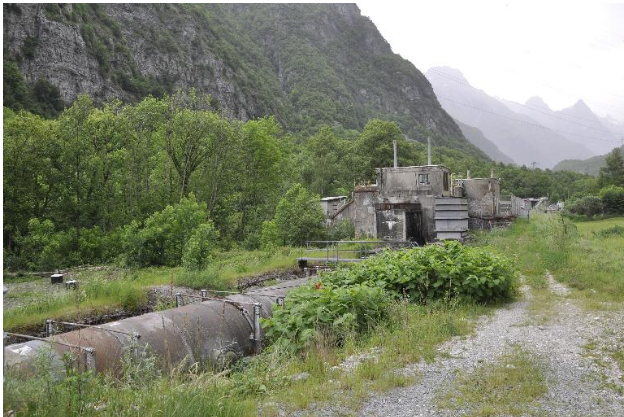
Vue des conduites forcées et des installations
