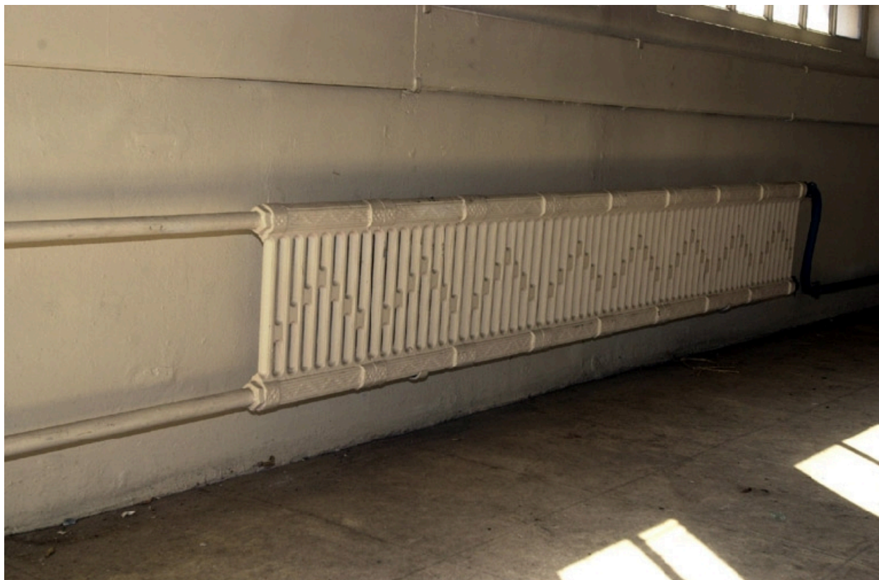
Système de chauffage central : radiateur
