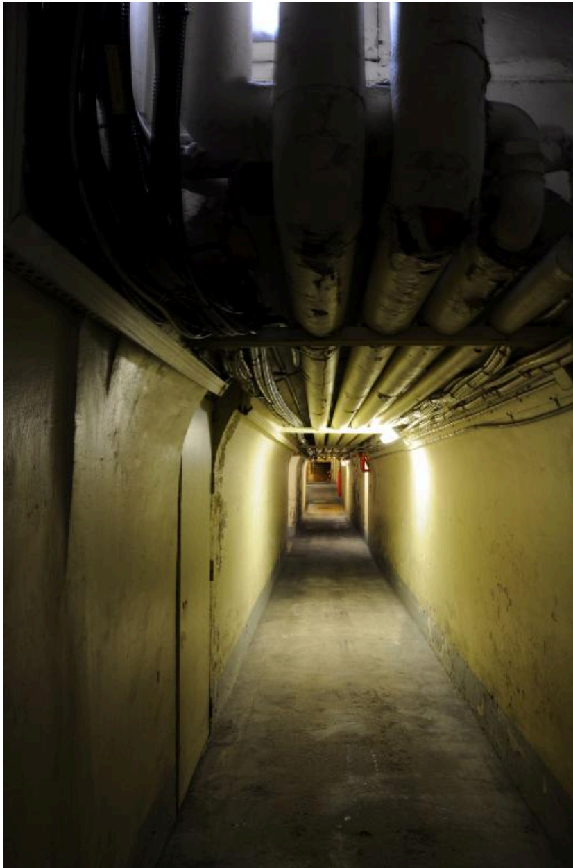
Galerie souterraine voûtée, reliant les pavillons Le Revard (bât. F) et Brachet (bât. B)
