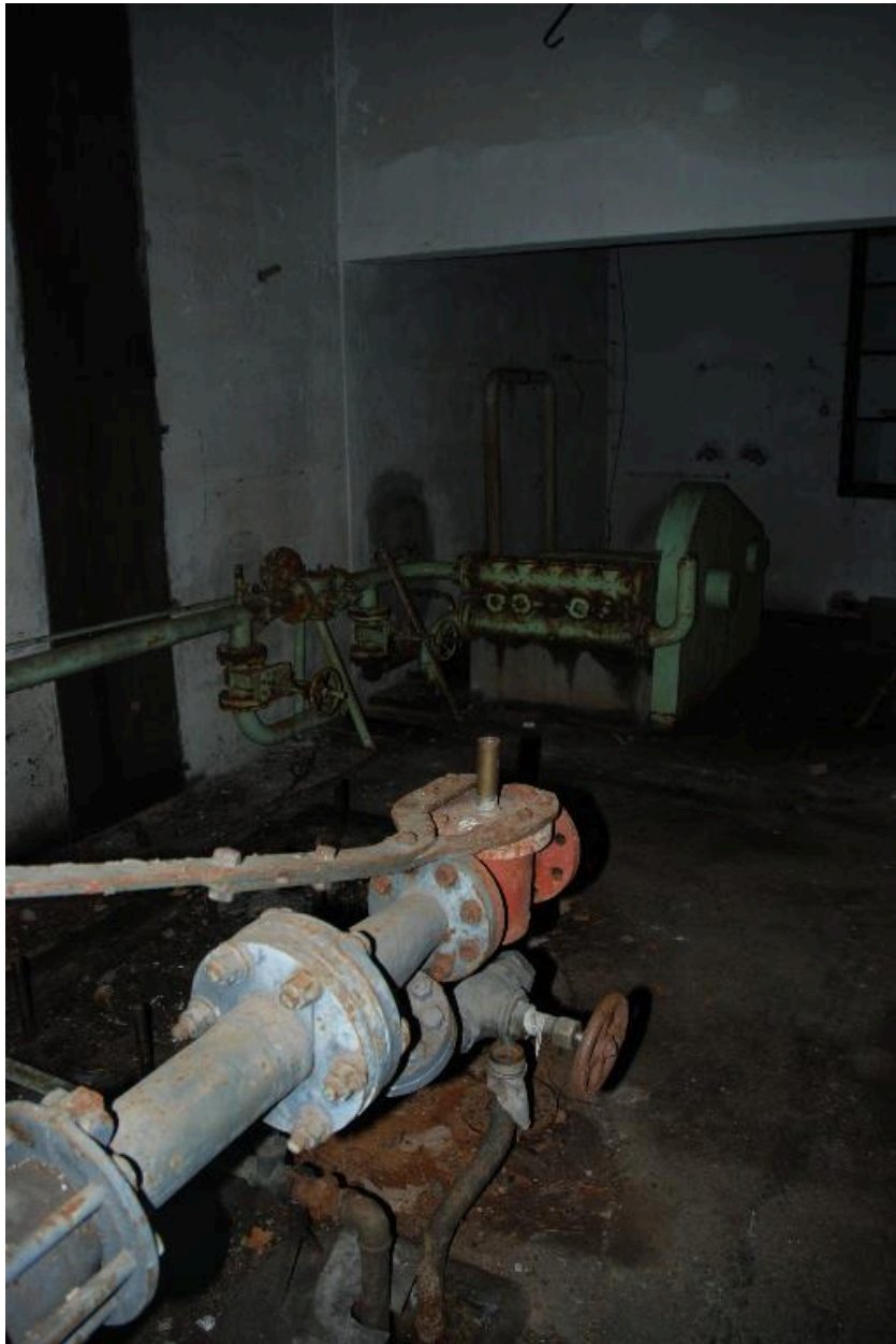
Station de pompage de la gare de Pré Japert, vue intérieure.
