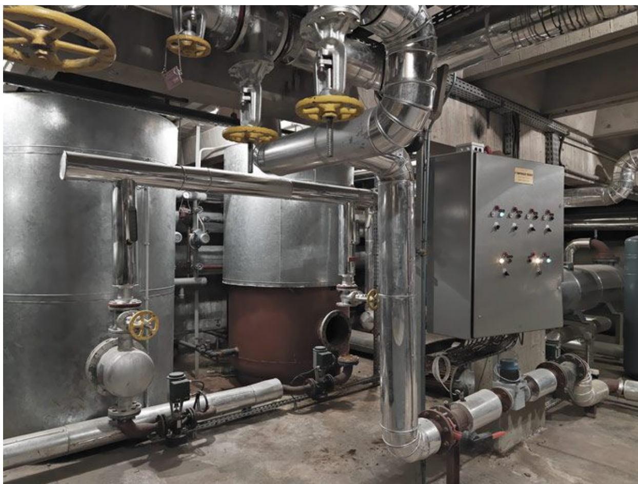
La sous-station de la galerie marchande. Le tableau électrique Ets Empereur frères
