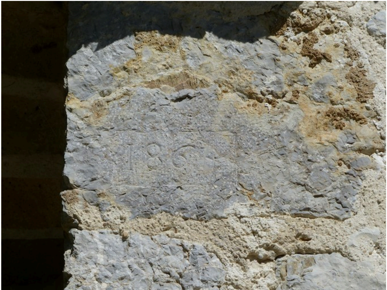
Chaîne d'angle en pierre de taille, avec date portée (1864). Entrepôt agricole au quartier de Font Nouvelle.
