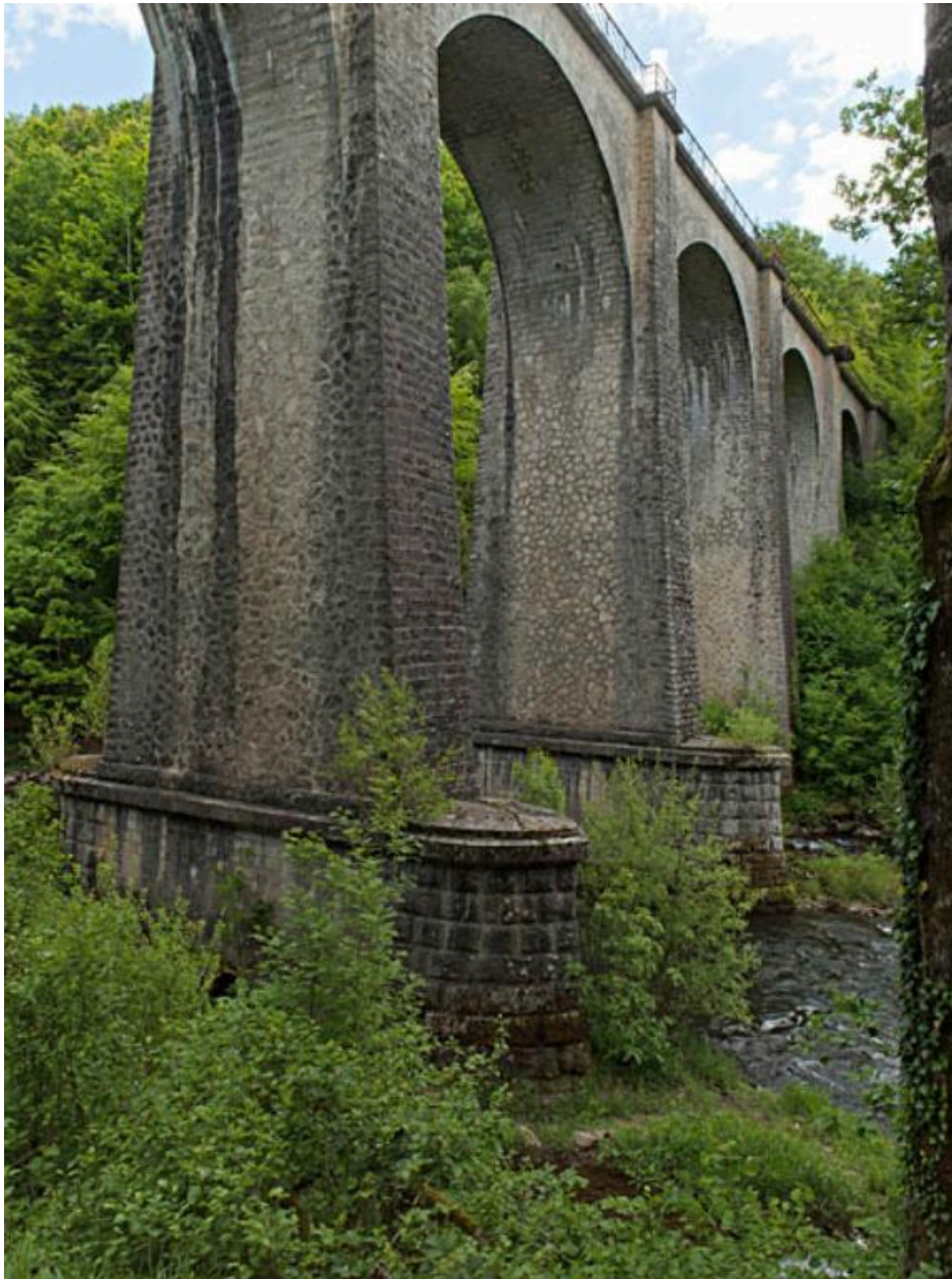
vue partielle des piles du viaduc de Nèpes, depuis les bords de la Cère.
