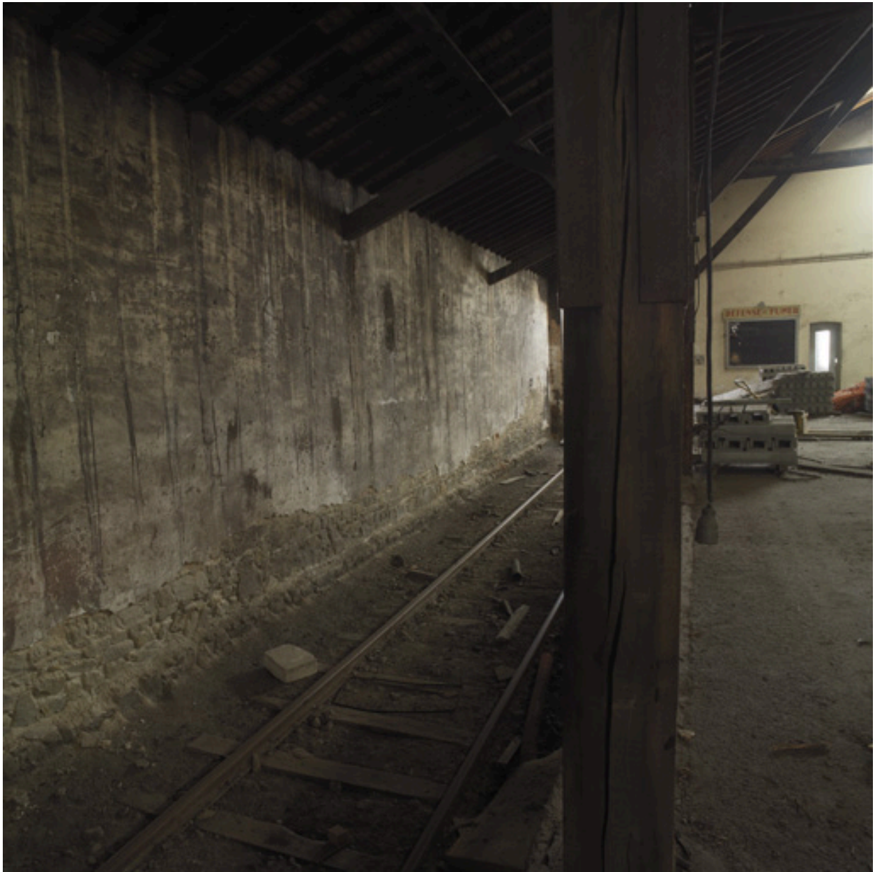
Le quai de déchargement des trains dans la gare de marchandises : détail.
