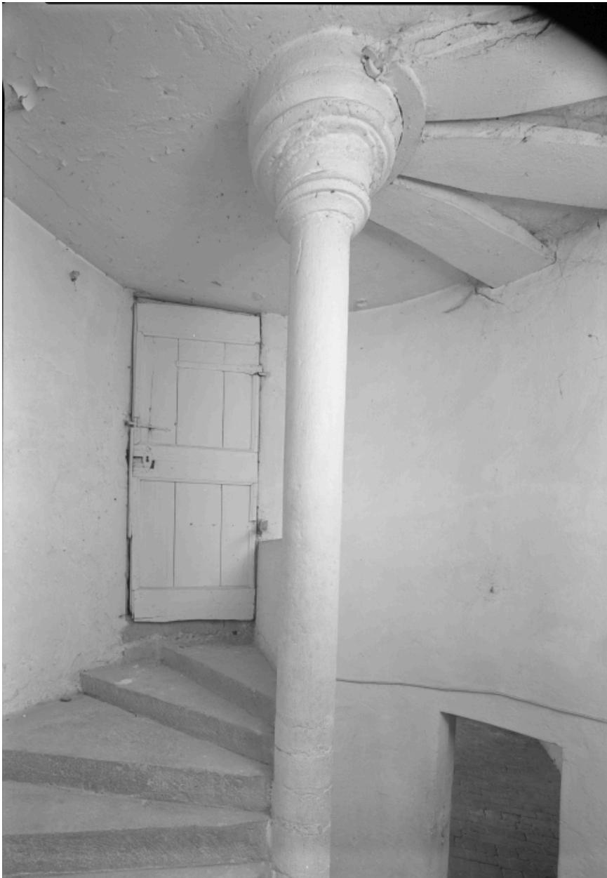
Couvrement de l'escalier en vis et départ de l'escalier de la tourelle.
