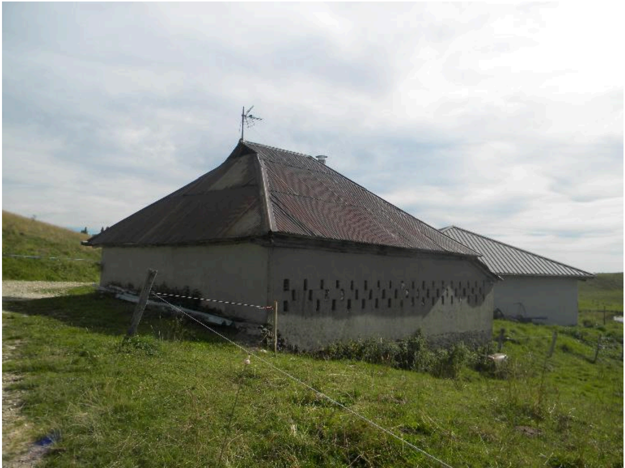
Vue de la façade nord de l'habitation avec les ouvertures du freidi.
