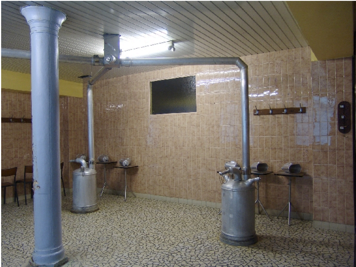
Salle de soin avec berthollet des mains et colonne de vapeur
