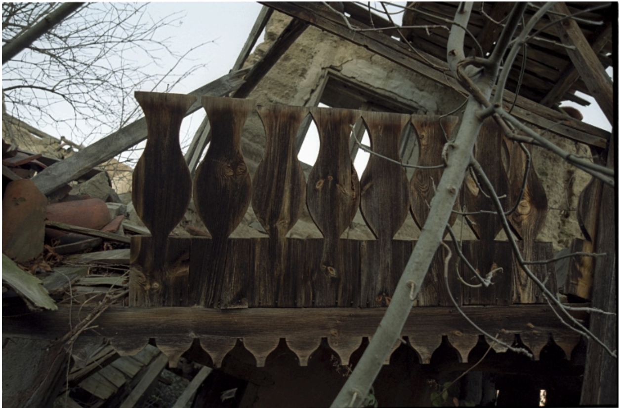
Saint-Sixte, Jay (1987 A3 902 b). Ferme en ruine, détail du garde-corps de l'aître.
