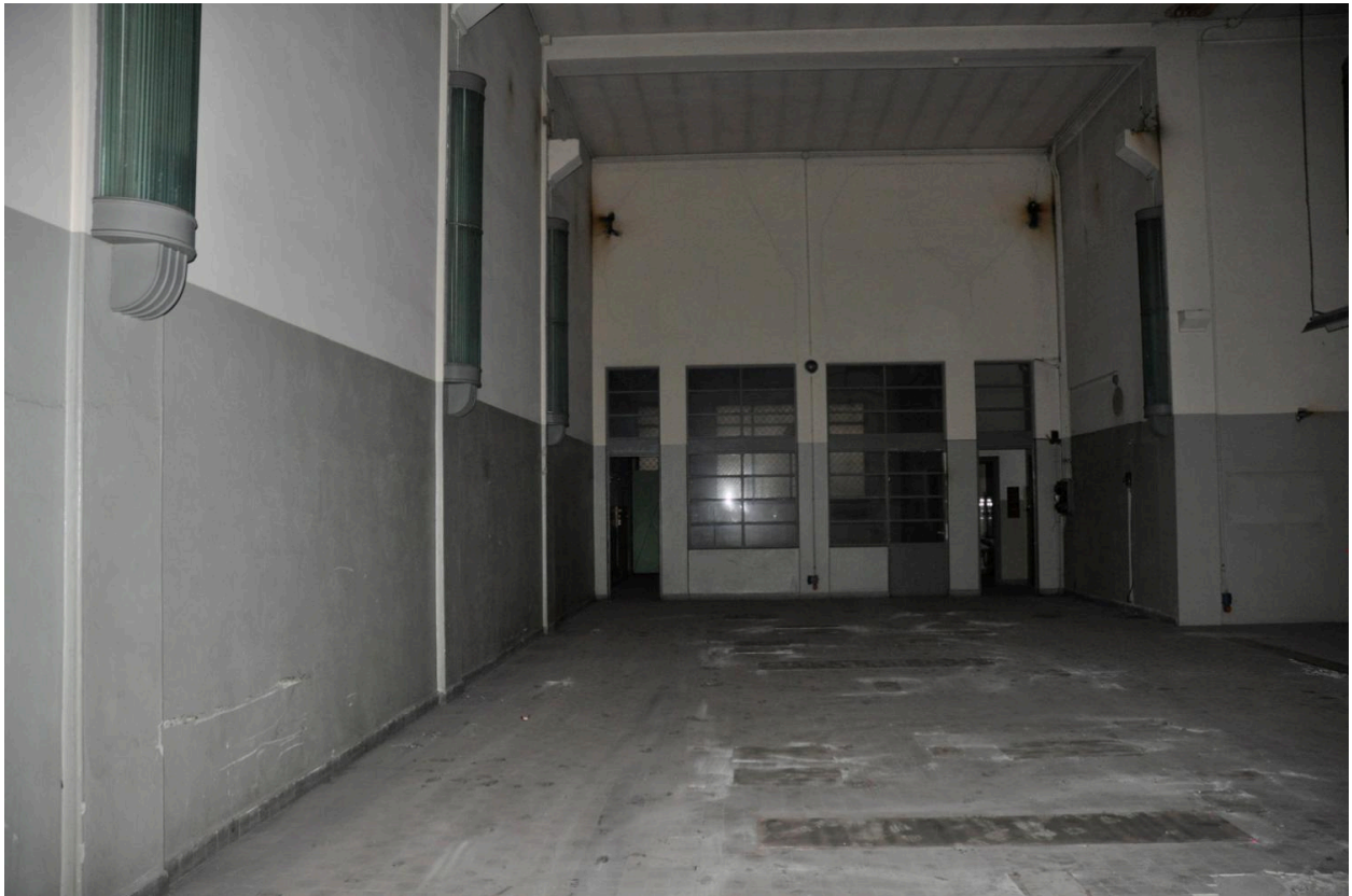
Salle des mutateurs rez-de-chaussée
