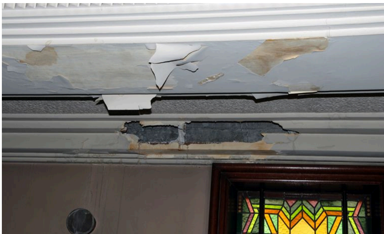
dégradation de la corniche, détail
