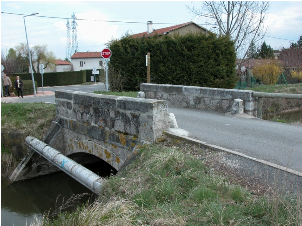
Ponceau sur le canal du Forez au Peyrot (1997 AY non cadastré, entre AY 93 et AY 98).
