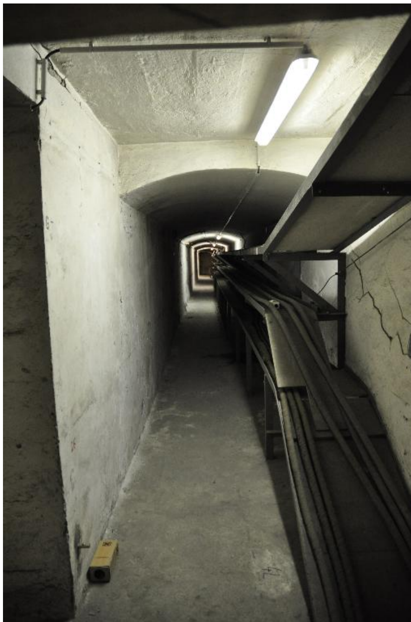
Vue des tuyaux dans les galeries au sous-sol
