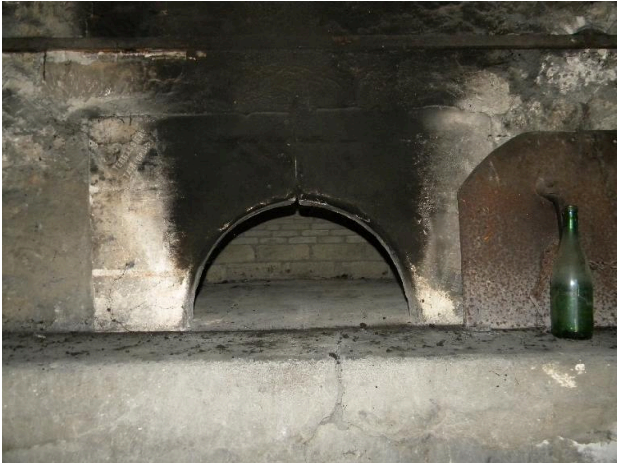
Vue de la bouche du four
