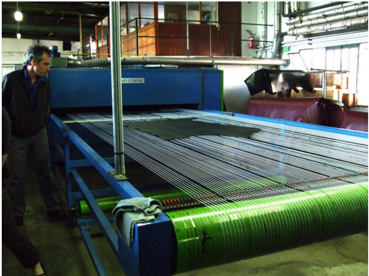
Vue intérieure : machine
